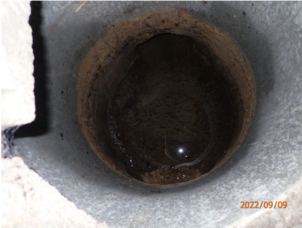
Foto Nr. 13: km 14'376 (Zone 5), Schacht rechts, Verschmutzung durch Feinanteile, Versinterungen
