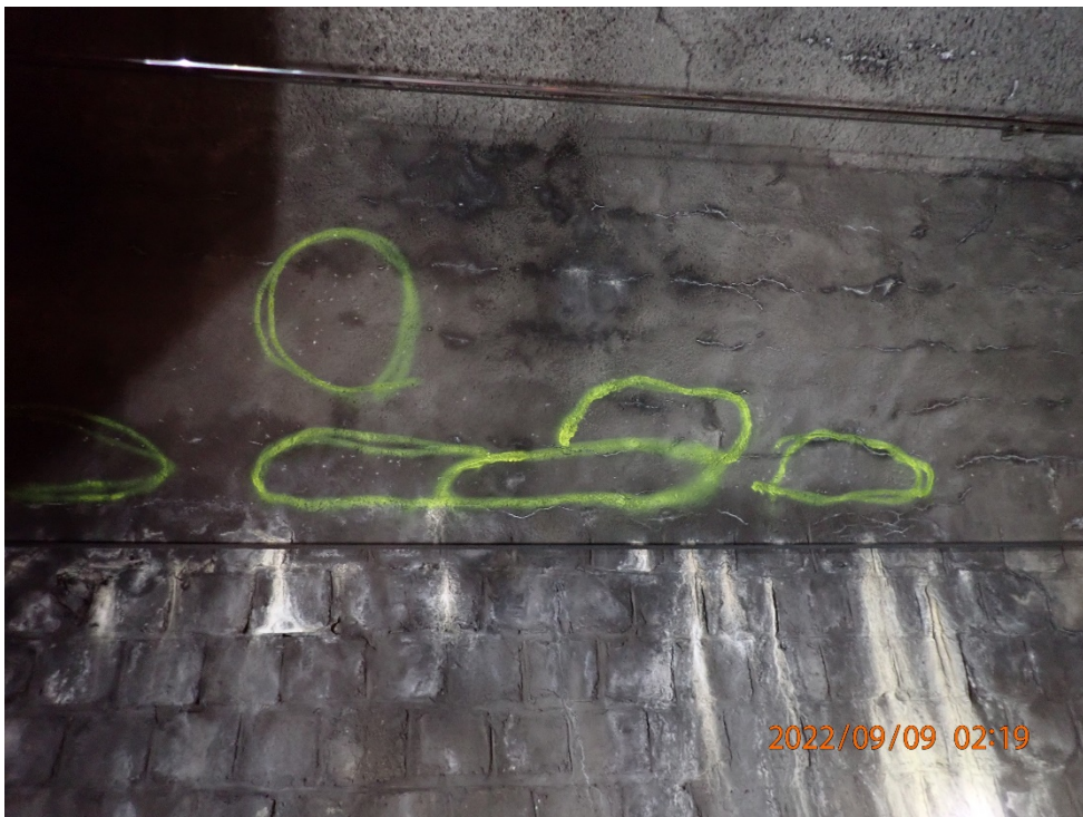
Foto Nr. 10: km 13'992 (Zone 11), Kämpfer links: Hohlstellen, zugesinterte Risse, Ausblühungen
