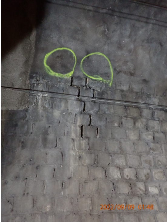
Foto Nr. 7: ca. km 13'947 (Zone 7), Parament links, Hohlstellen und leere Fugen < 10 cm
