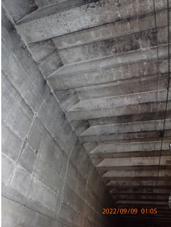
Foto Nr. 3: ca. km 13'900 (Zone 1), Decke, Verfärbungen, Rissfläche
