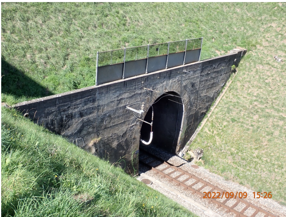
Foto Nr. 2: Portal Seite Grosshöchstetten, grossflächige Abplatzungen, Hohlstellen, Risse, zugesinterte Rissfläche, Pflanzenbewuchs
