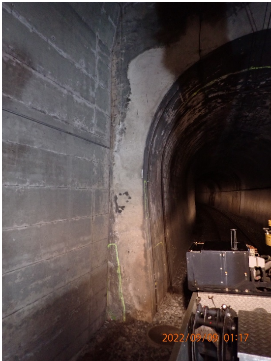
Foto Nr. 4: km 13'914 (Zone 3), Parament links, Hohlstelle, zugesinterte Rissfläche
