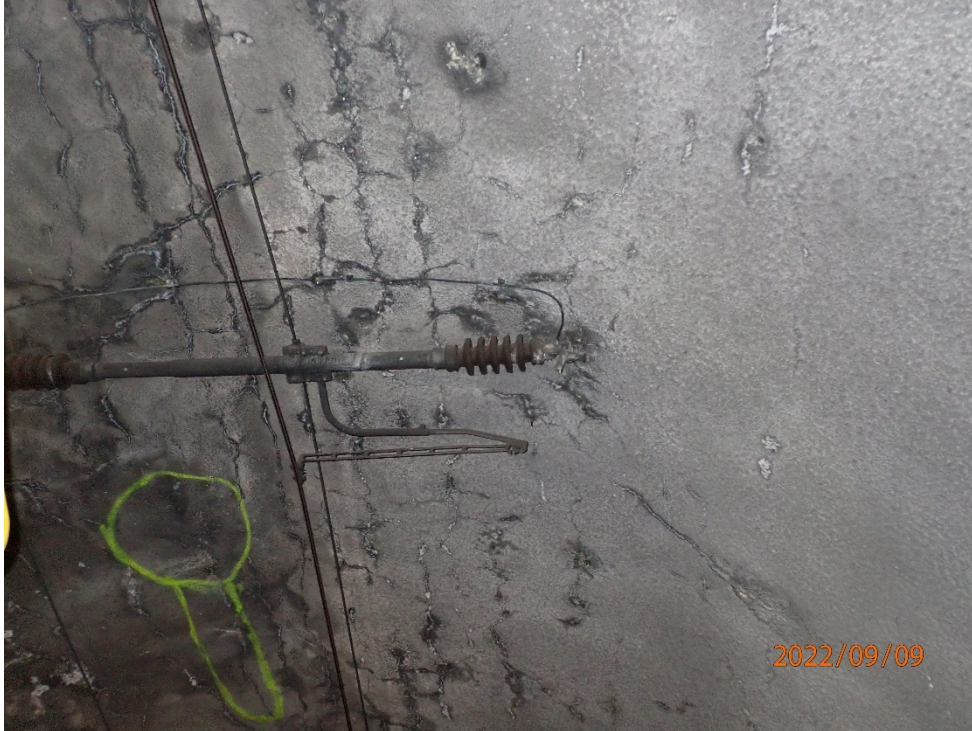
Foto Nr. 11: km 14'000 (Zone 12), First / Kämpfer rechts, Tropfstellen, Stalaktiten, zugesinterte Rissfläche, Hohlstellen
