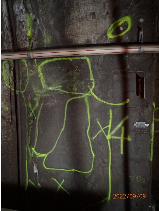
Foto Nr. 5: km 13'916 (Zone 4), Parament rechts, Riss > 5.0 mm, Abplatzungen, Hohlstellen
