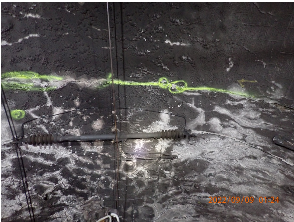
Foto Nr. 6: km 13'916 (Zone 4), Firstbereich, klaffender Riss, zugesinterte Rissfläche
