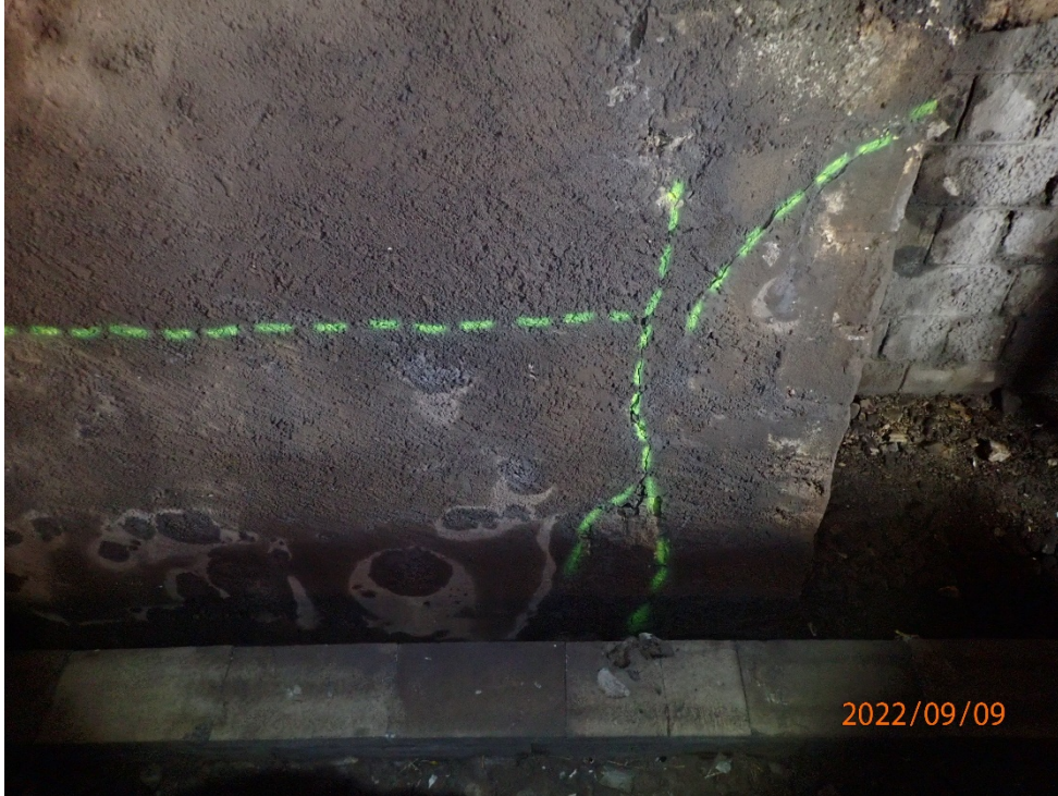
Foto Nr. 9: km 13'967 (Zone 9), Parament rechts: Risse < 1.0 bis 2.0 mm, Abplatzungen, Feuchtstelle
