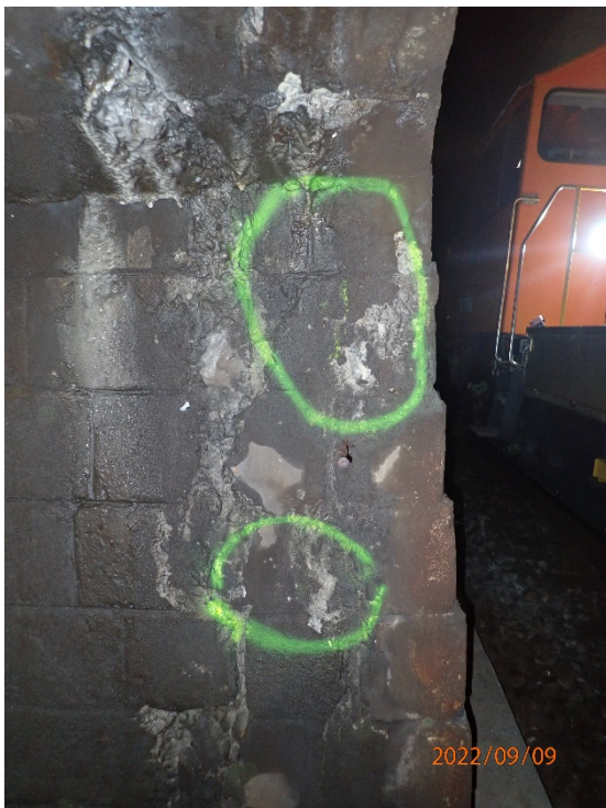
Foto Nr. 8: km 13'964 (Zone 8), Nische rechts, Hohlstellen, abgebrochene MW-Steine, Feuchtstelle, Riss < 5.00 mm
