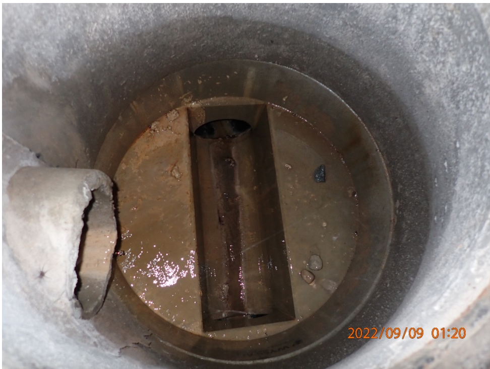
Foto Nr. 12: km 13'914 (Zone 3 / 4), Parament links, Schacht, leichte Verschmutzung durch Feinanteile
