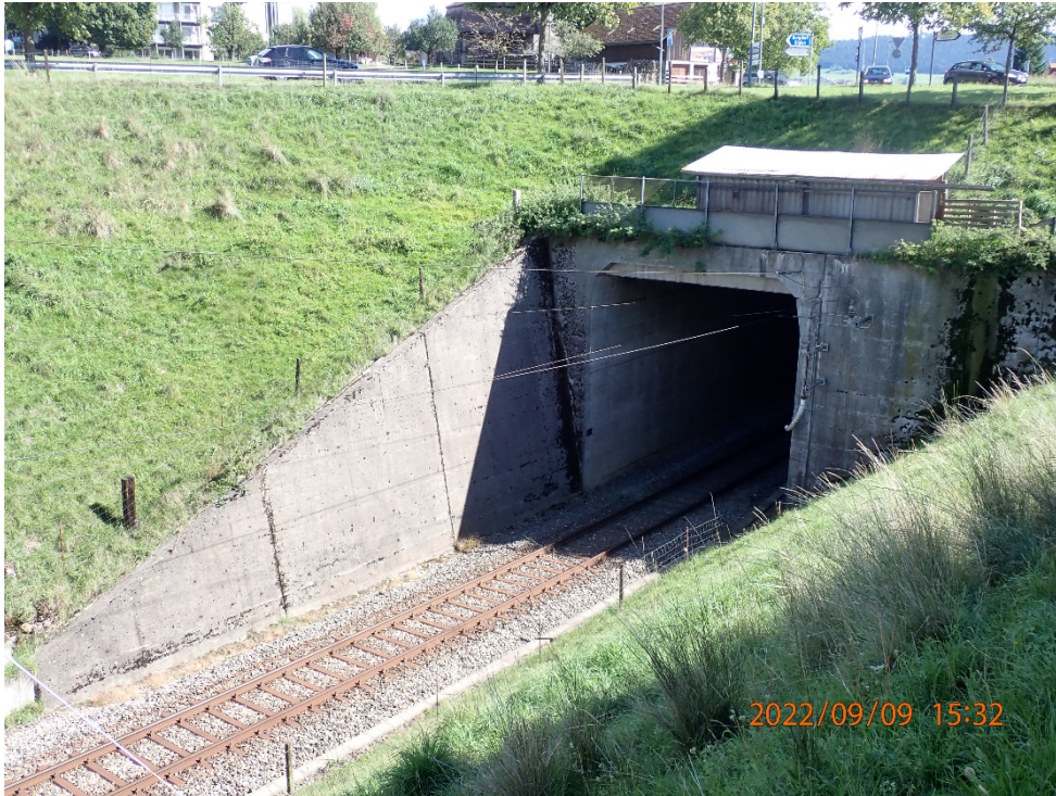
Foto Nr. 1: Portal Seite Biglen, fehlende Absturzsicherung, Abplatzungen, Risse, Ausblühungen, Pflanzenbewuchs
