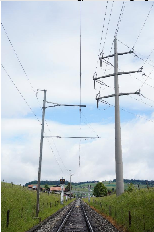
12 km 13'500, Bahntrasse mit Hochstromleitung, Blickrichtung Biglen
