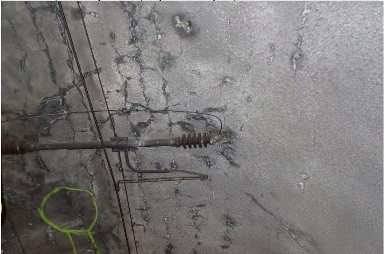
103 km 14'000, First/Kämpfer rechts; Tropfstellen im SpriBe, versinterte Risse
