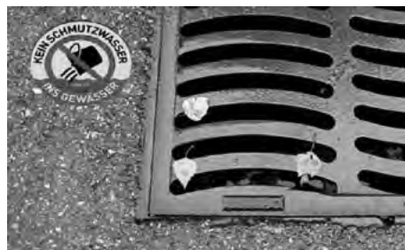
Hier warnt eine Beschriftung davor, dass der Schacht in einen Bach, einen See oder ins Grundwasser führt.
